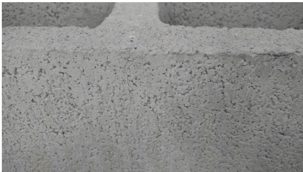
Figura 5: Fissura apresentada no traço 02 do bloco sem resíduos de madeira
