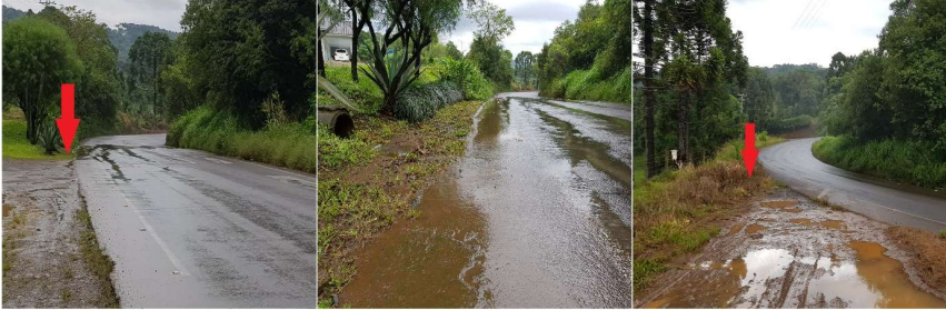
Figura 3: Início Sarjeta de Corte/ Problemas Causados e Final da Sarjeta
