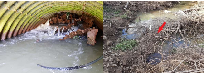
Figura 1: Obstrução e Montante do Bueiro de Grota
