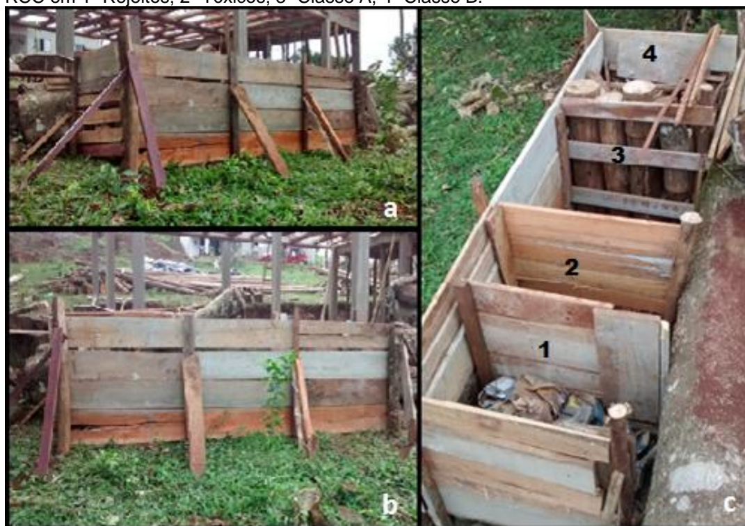
Figura 1 - Baias construídas na obra de construção nova para acondicionamento de RCC: Baias construídas e ao fundo a obra (a) e Vista frontal das baias (b): Acondicionamento de RCC em 1- Rejeitos; 2- Tóxicos; 3- Classe A; 4- Classe B.
