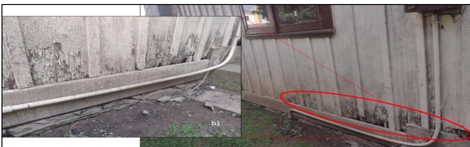
Figura 15 –Apodrecimento de madeira (a) e detalhe da patologia de apodrecimento (b).
