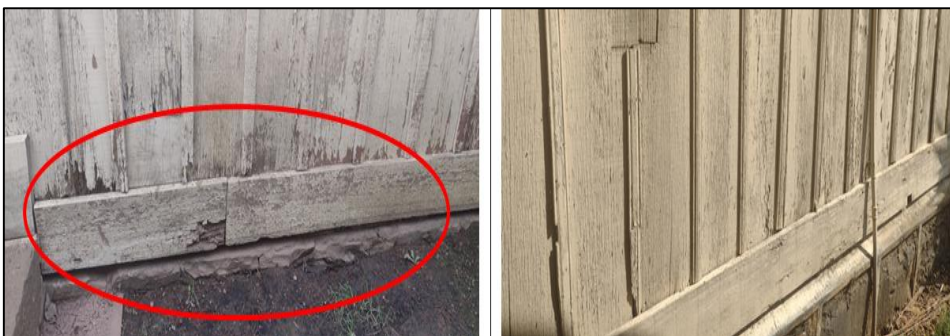
Figura 16 – Patologias Identificadas na Estação Ferroviária Rio das Antas: Apodrecimento de madeira.
