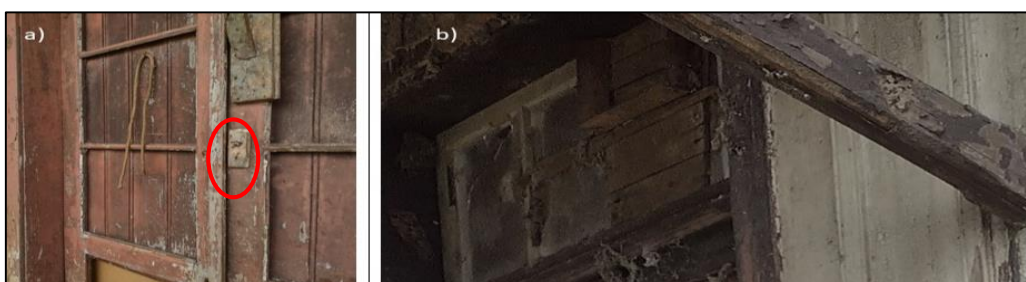
Figura 5 – Descascamento da tinta e oxidação(a) e apodrecimento e deterioração da madeira (b).
