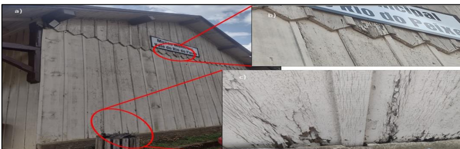
Figura 17 –Apodrecimento de madeira na fachada lateral (a) e Detalhes (b e c).
