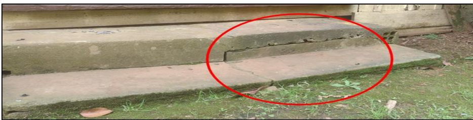
Figura 14 –Trinca em espelho e degrau.
