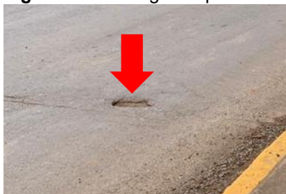
Figura 8 – Patologia na pavimentação: Buraco ou Panela
