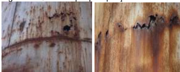
Figura 2 – Corrosão por precipitação de ácido
