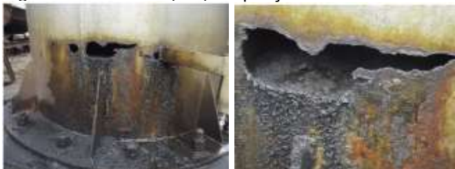
Figura 1 – Corrosão por precipitação de ácido
