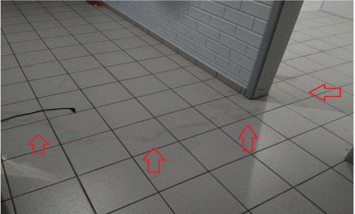
Figura 2 – Derramamento do produto direto no revestimento
