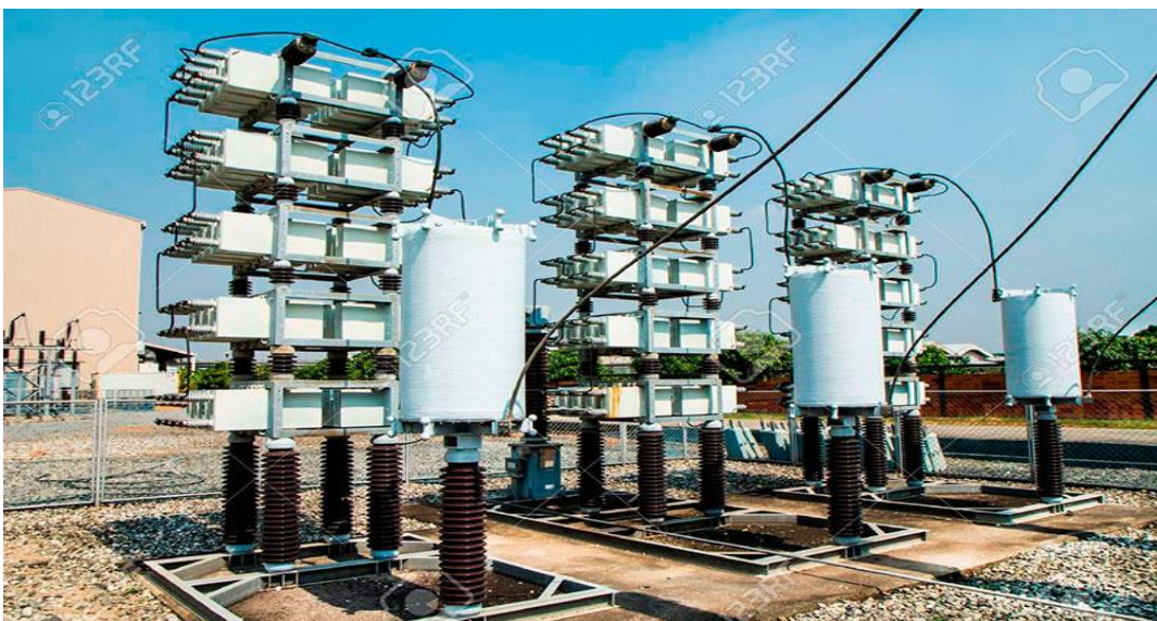
Fig 06 - Banco capacitor Fonte: MP Engenharia Elétrica
