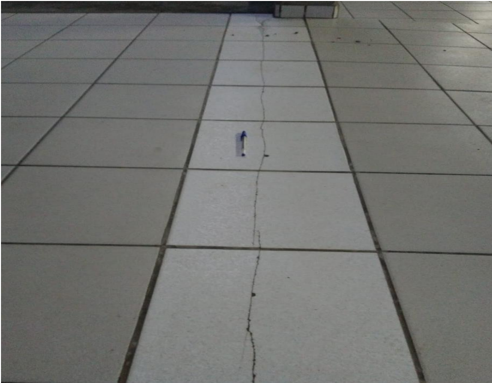
Figura 14 – Trinca na parte de cima da Rampa
