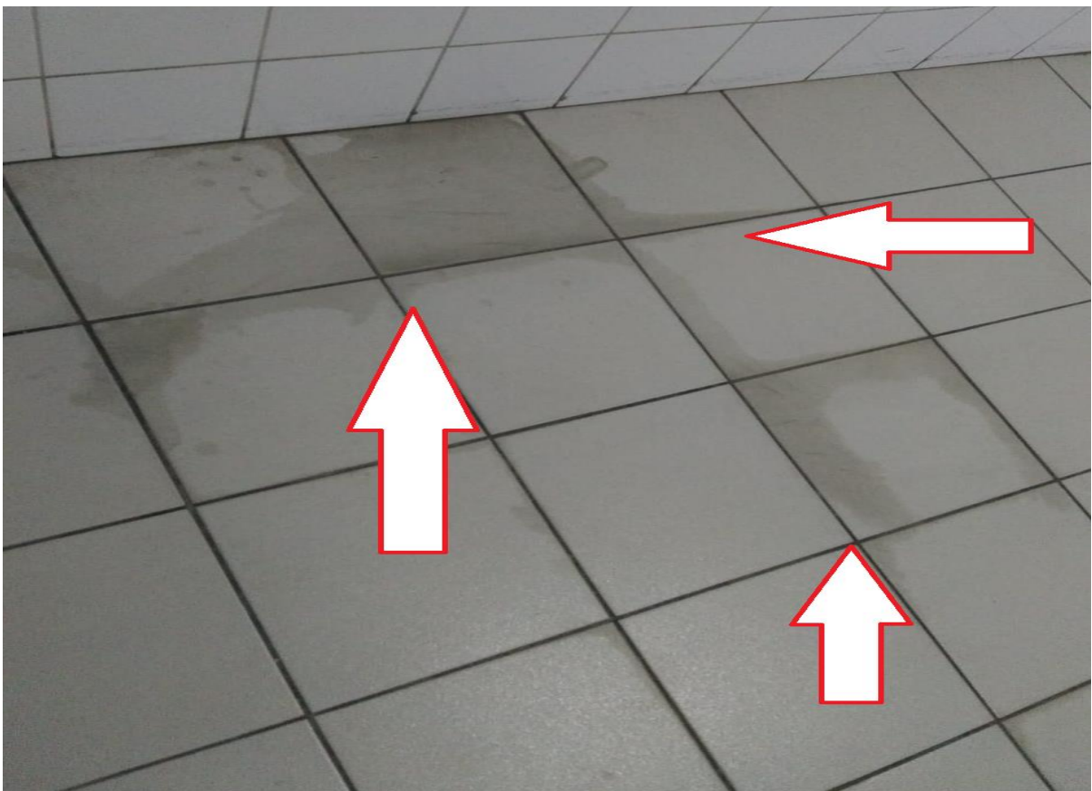
Figura 1 – Manchas por produto químico, aplicado na superfície
