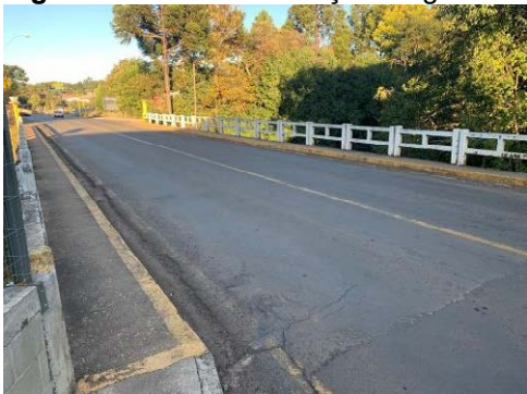
Figura 4 – Biodeteriorização no guarda-corpo da ponte
