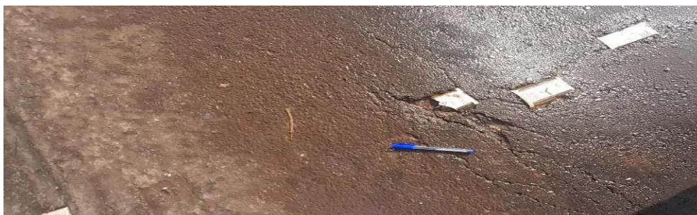
Figura 02 – Trincas e fissuras
