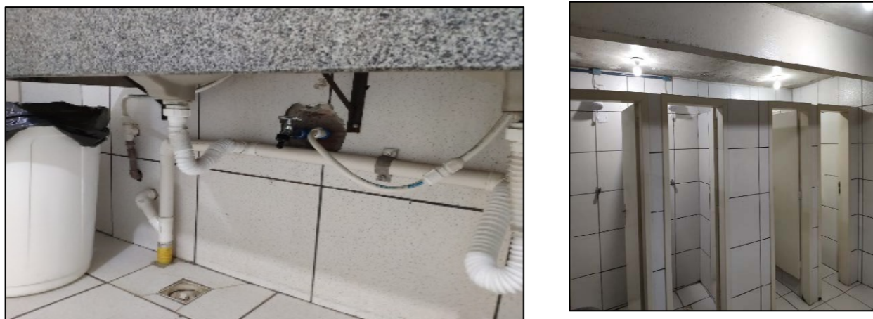
Figura 3 – Estruturas em mau estado
