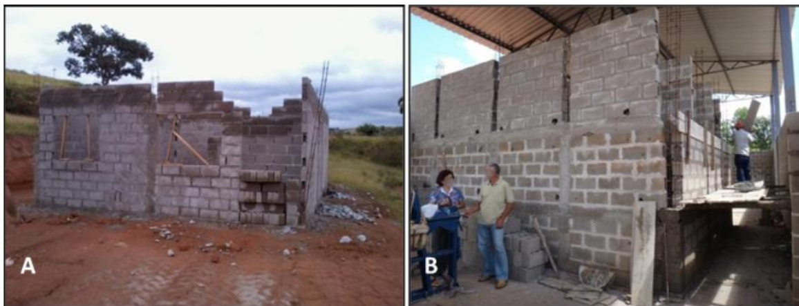
Figura 1: (A) Construção da Sede da AFASA; (B) Trabalho dos associados na Construção.
